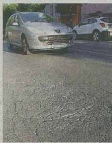
Asfalto spaccato in via Fiorenzuola
